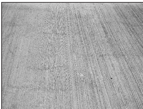
FIGUUR 7: Tipiese kraakpatrone waargeneem op die oppervlak van die betonpad.
