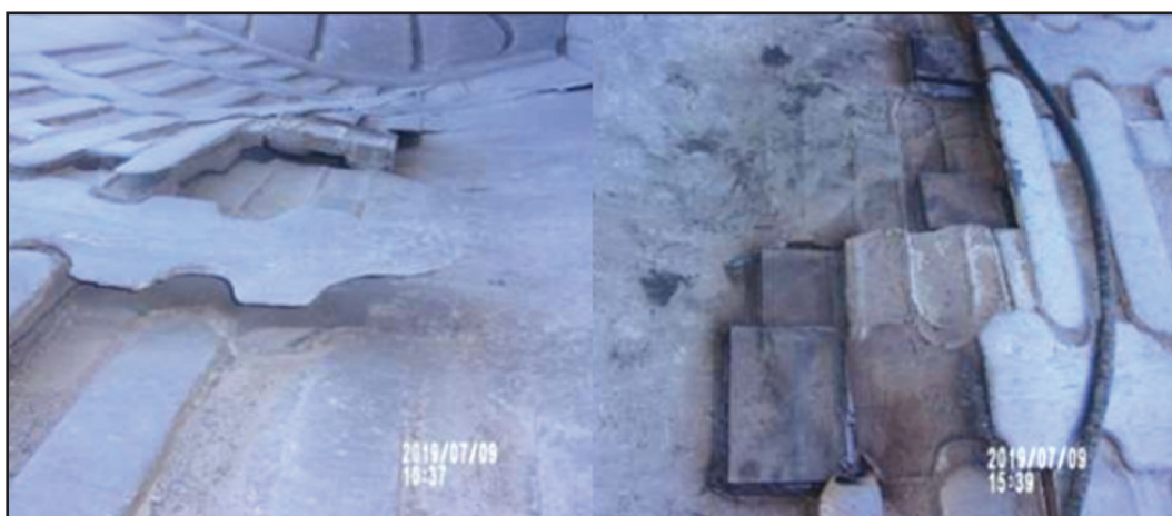
FIGUUR 6: Standaard slytpakket: skade (LK) en herstel (RK). (JCB-Gearvest (Pty) Ltd, 2019).
